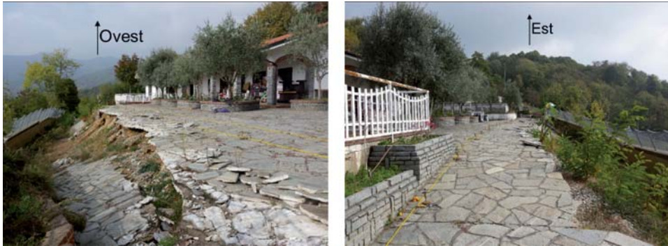
Fig. 4 - Dissesto del ciglio di un piazzale lastricato (fronte di 80 m).
